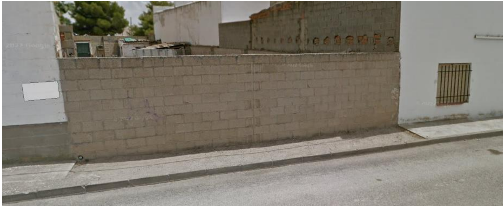
Calle San isidro foto2: Detalle de acera sin terminar, intransitable con carros y sillas de ruedas:
